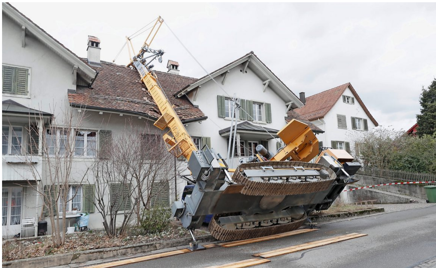
Der Kran stürzte auf ein Hausdach an der Märktgass in Rafz. Verletzt wurde niemand. Foto: Paco Carrascosa
